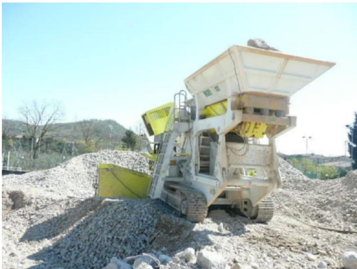
Figura 62: Esempio impianto di frantumazione mobile
