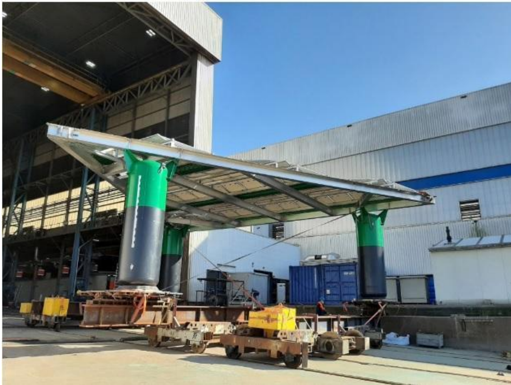
Figura 32 — Esempio di assemblaggio in banchina piattaforma triangolare fotovoltaica (Fonte: solarduck.tech )
