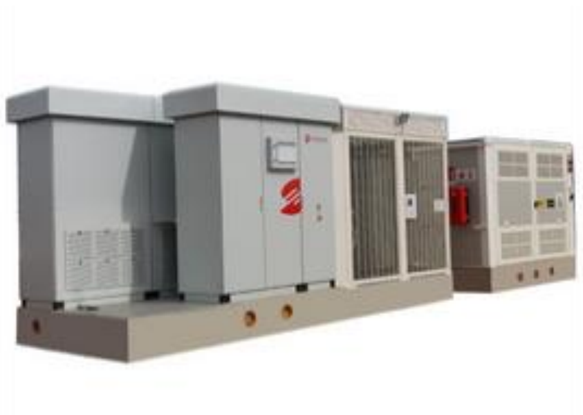
Figura 4: skid "Enertronica Santerno"
