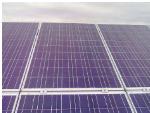
Tavola n. 21: Modulo con superficie compromessa
