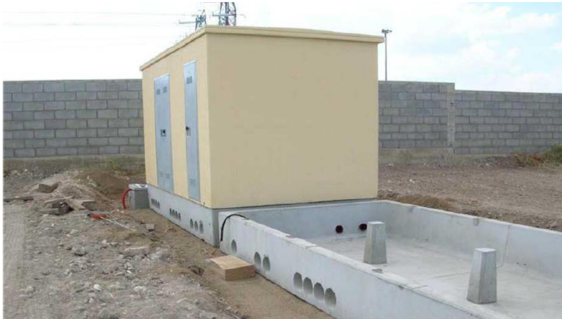
Figura 33: Cabina elettrica di smistamento
