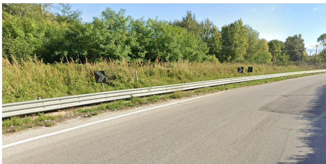
Foto 7-Ripresa della viabilità esistente, interessata dalla realizzazione del tratto di cavidotto di connessione, di circa 100 metri, all'interno della ZSC IT8010027 “Fiumi Volturno e Calora Beneventano”, con sul lato sinistro, vegetazione alloctona e infestante, principalmente Ailanto ( Ahilantus altissima ) e Robinia ( Robinia pseudacacia ). Bassa valenza ecologia e soggetta a disturbo antropico costante e irreversibile. L'intervento non aumenterà in alcun modo il livello di disturbo già presente.
