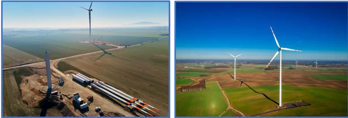
Figura 10: Riprese fotografiche di esempi di piazzole tipo in fase di montaggio e di esercizio
