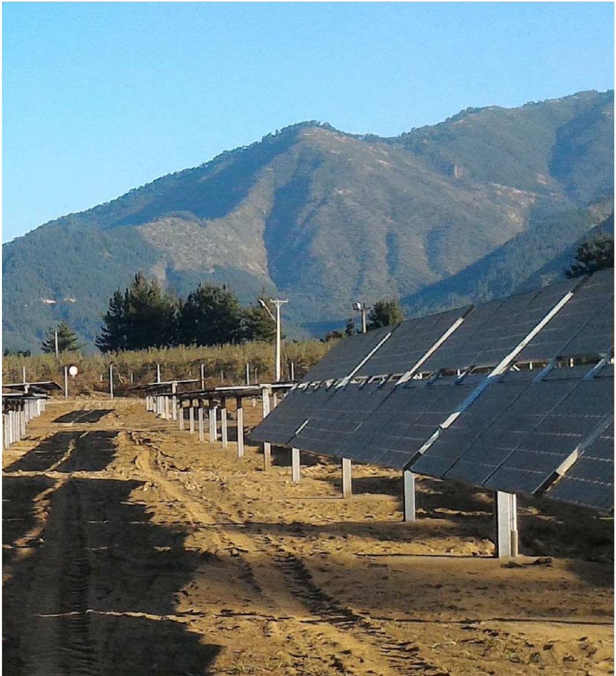
Fig. 6 Disposizione dei moduli fotovoltaici sui tracker
