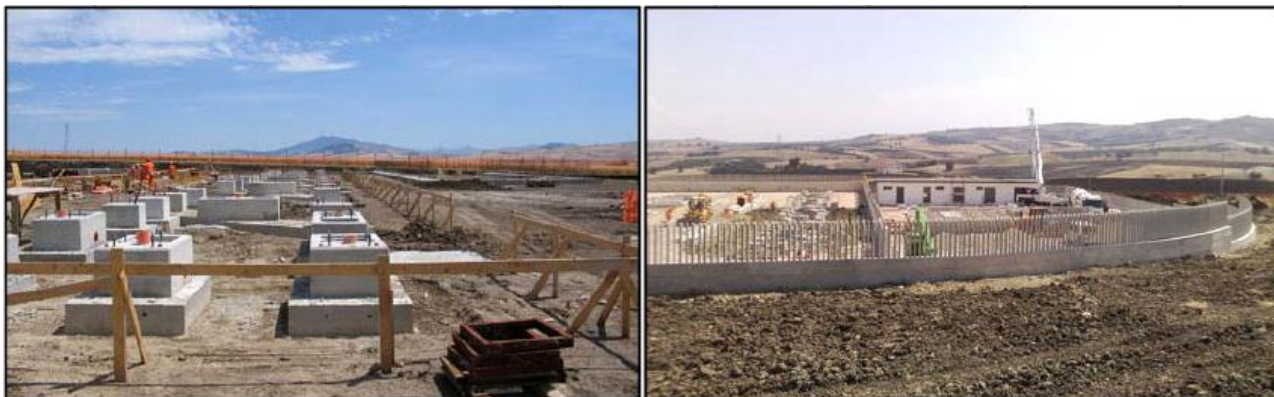
Figura 26: Sottostazione elettrica MT/AT
