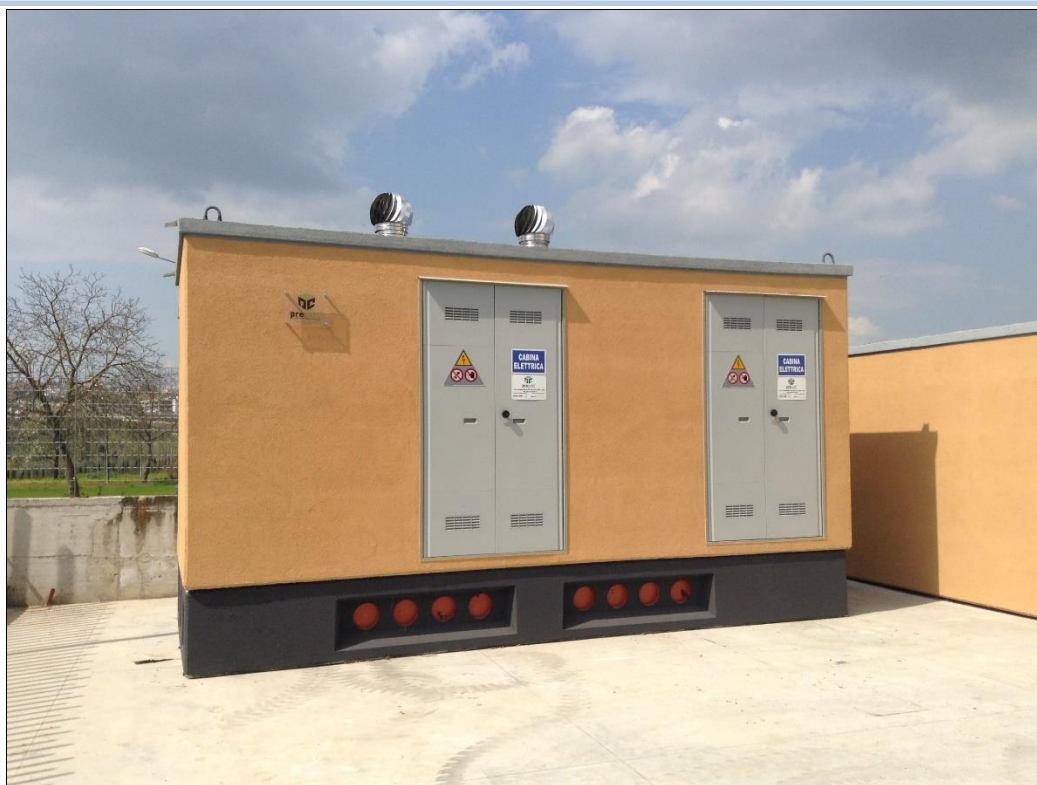
Figura 14: Tipica cabina di smistamento containerizzata
