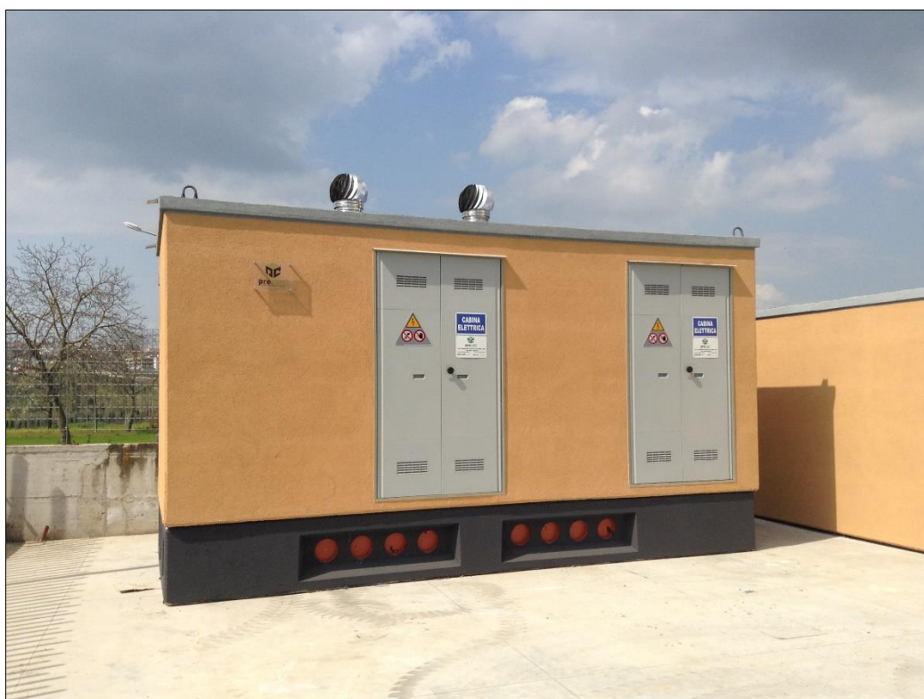
Figura 7: Tipica cabina di smistamento containerizzata
