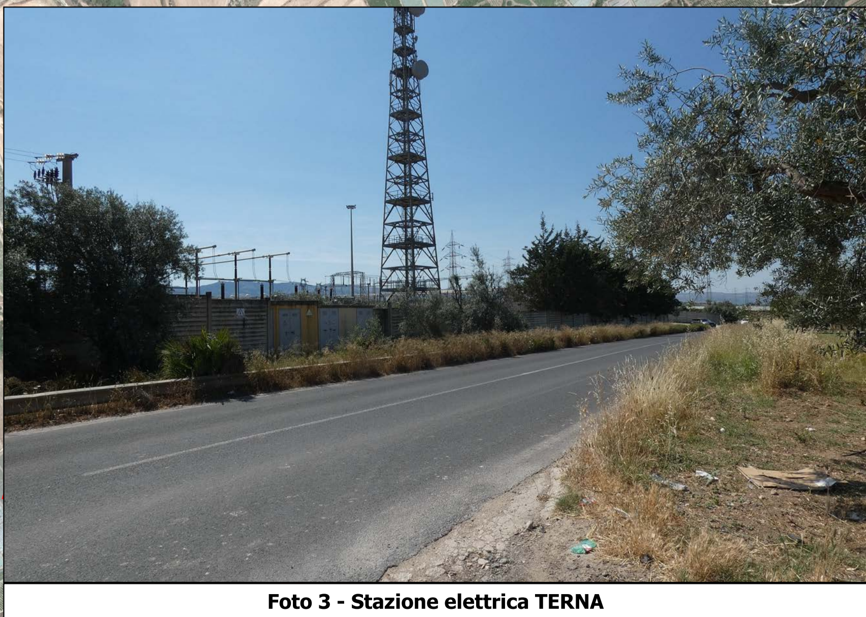
Foto 3 - Stazione elettrica TERNA
