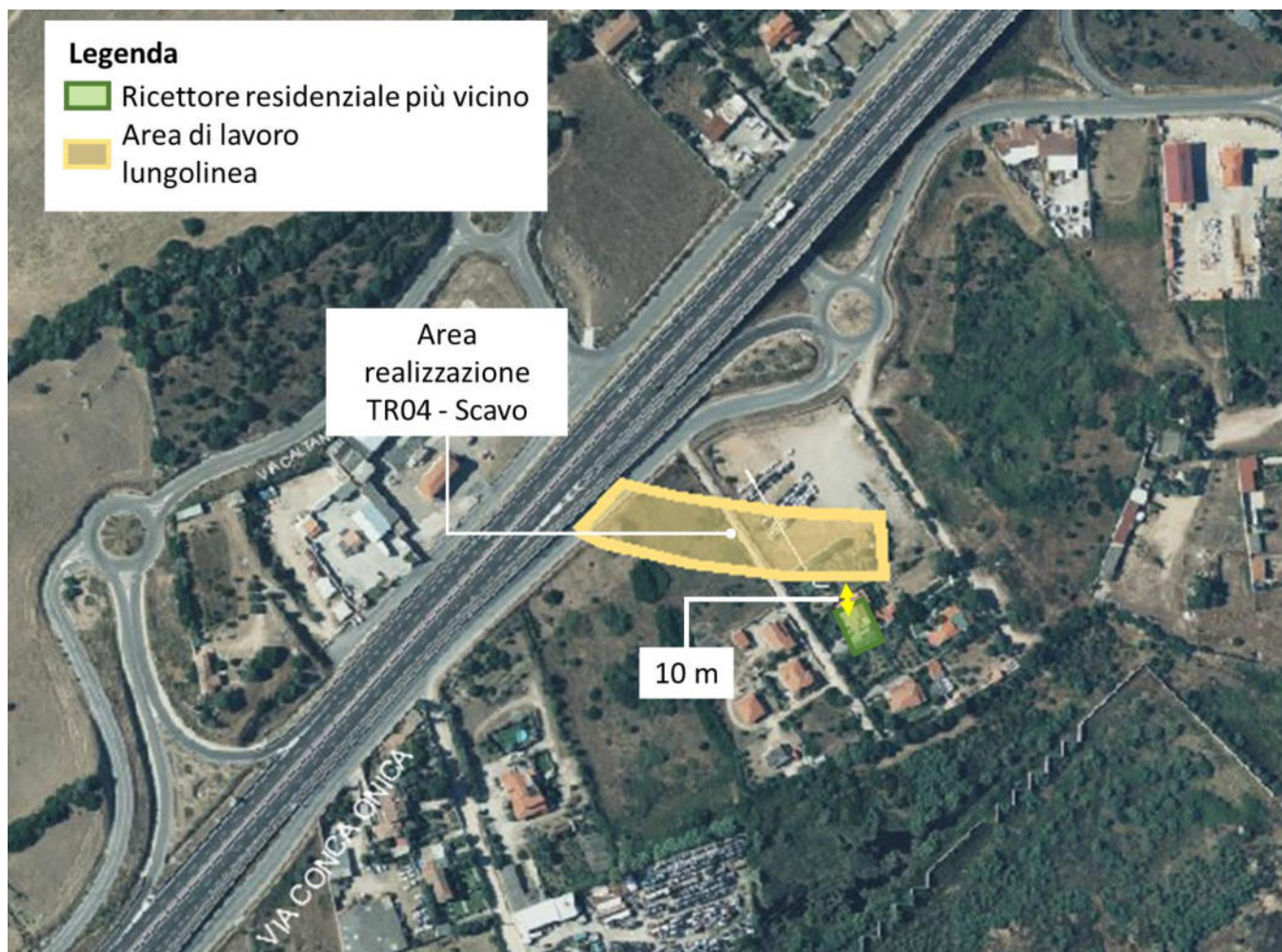
Figura 6-19 Scavo realizzazione trincea TR04 - localizzazione delle aree di cantiere e distanza dal ricettore residenziale più vicino
