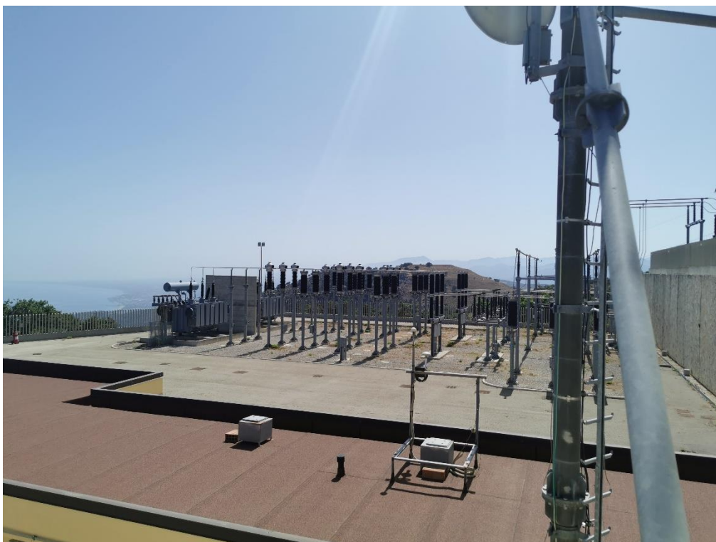
Figura 4: Punto di vista PV2: ripresa fotografica della SSE “Minerva” esistente (coordinate 501182.00 m E 4215109.00 m N)
