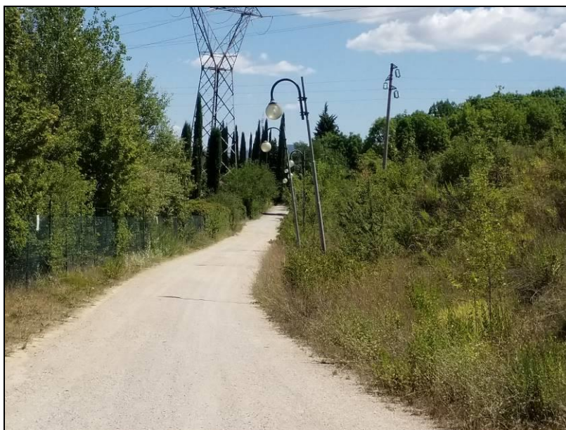
Figura 8.4 Serie di lampioni per l'illuminazione stradale inclinati da movimenti di terreno superficiali, sulla strada di collegamento tra via della Valtiera e la str. Cimitero Collestrada - Madonna di Campagna.
