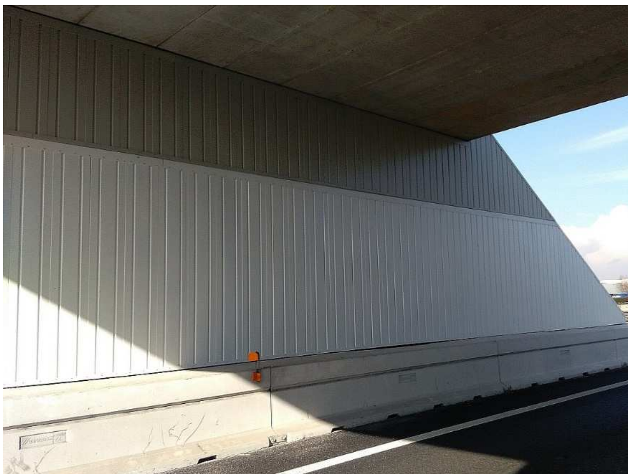
Figura 5.10 Esempi di pannelli fonoassorbenti alle pareti di una galleria
