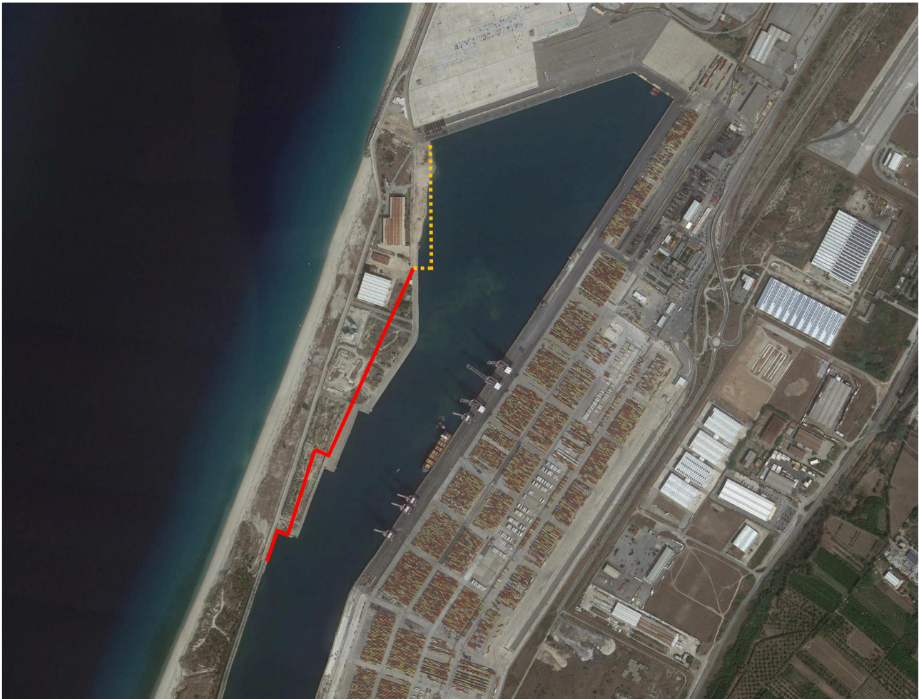
Figura 1 Sovrapposizione intervento su foto aerea. In rosso il nuovo profilo di banchina, in giallo la banchina in corso di realizzazione
