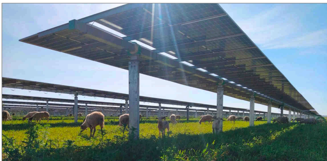
Strutture di sostegno e moduli – fotografia
