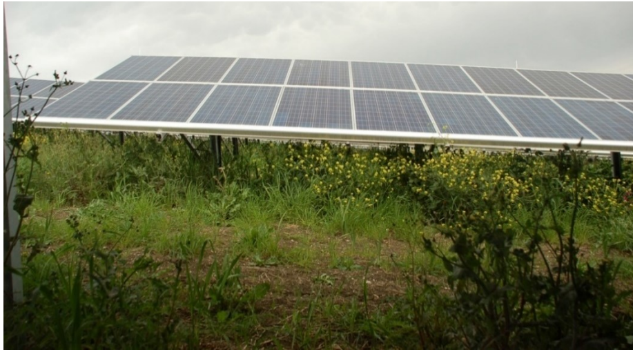
Figura 54 - Caso studio Parco Fotovoltaico "Villalba di Gesù" da 5 MW (Foto G. Filiberto)
