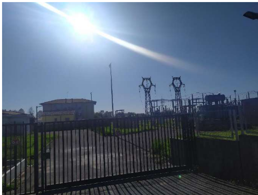
Foto 23 bis – Particolare Ingresso cabina primaria "Palmanova"
