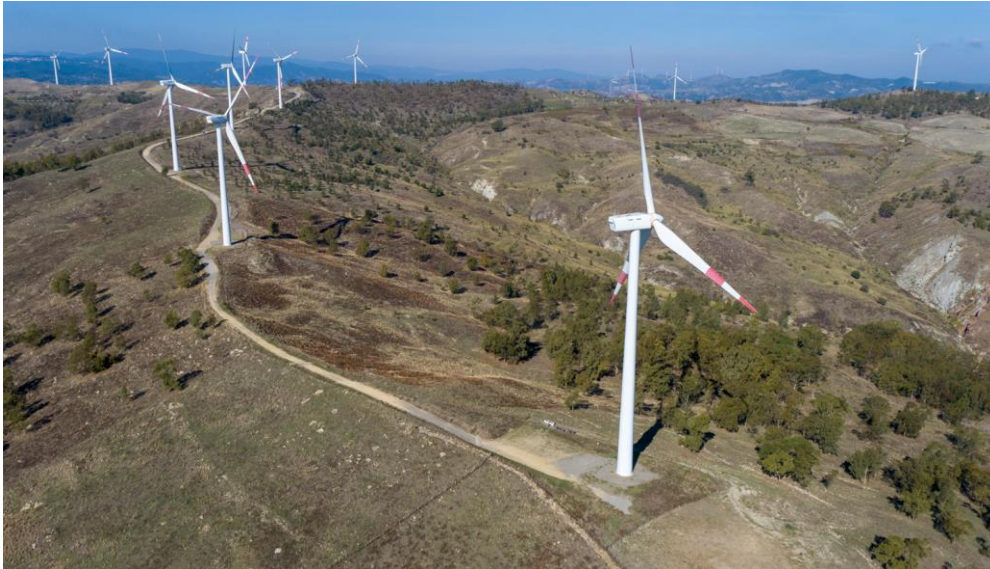
Foto 2 Foto dell'attuale impianto di Melissa Strongoli
