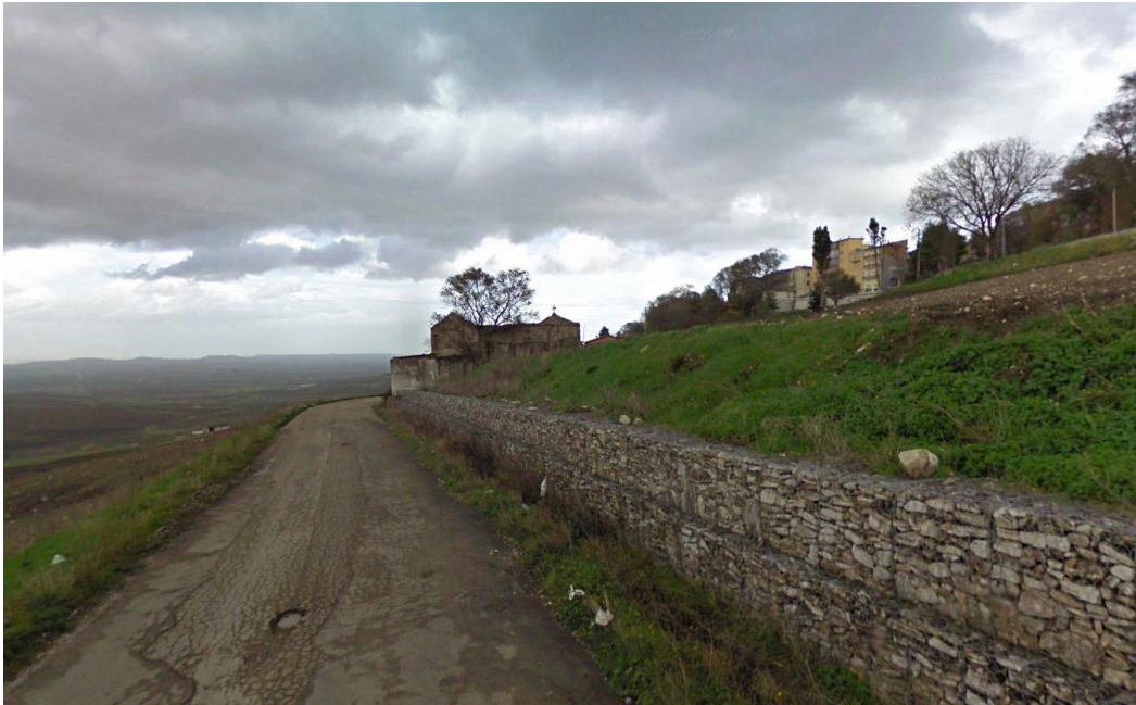
Figura 8 – Opere di contenimento controterra con gabbionate.
