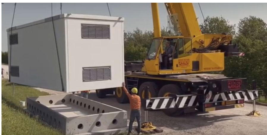
Figura 40: Fornitura e posa in opera delle cabine di campo e dei locali tecnici
