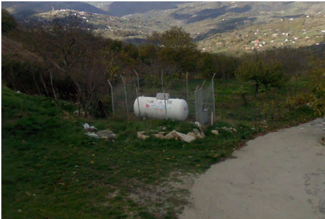
Figura 2 – Cisterna di GPL analizzata
