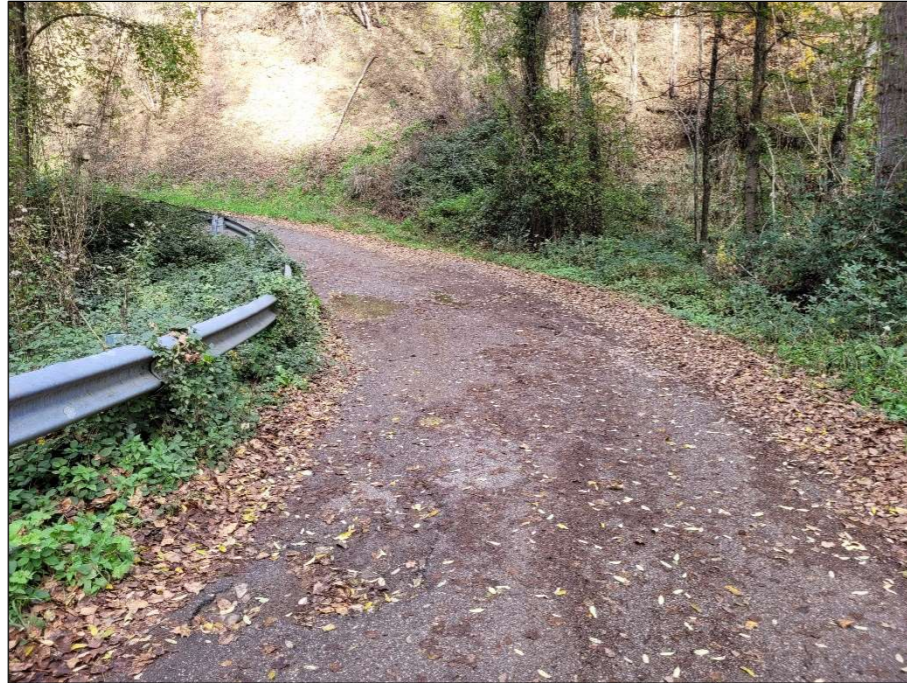
Foto 21 – Visa dell'attraversamento stradale in curva del corso d'acqua demaniale guardando verso Est.
