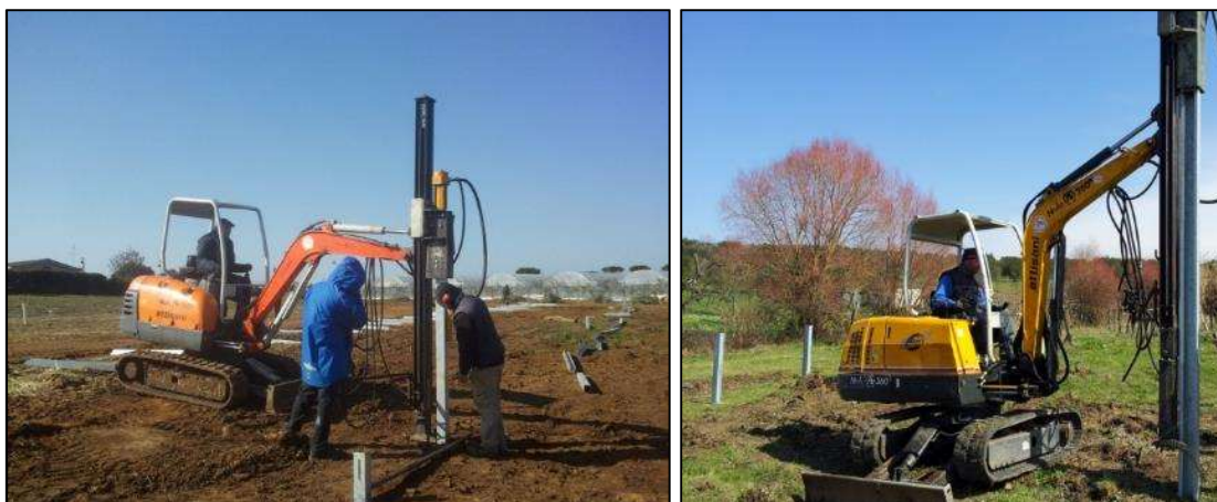
Figura 68 - Tipologia di installazione delle strutture di sostegno dei moduli FTV con macchina battipalo
