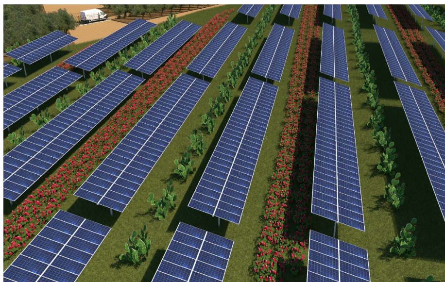
Figura 3-1 – Esempio di impianto agrivoltaico
