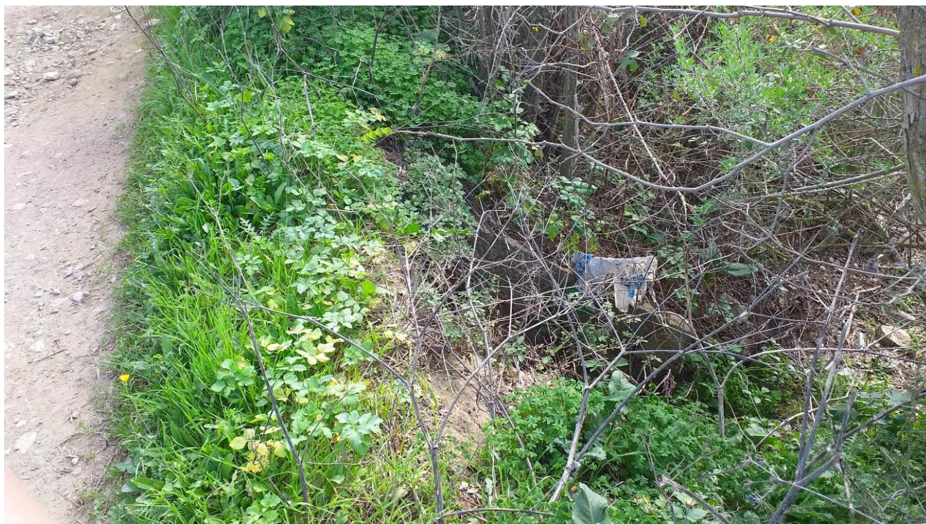
Figura 8: foto del ponte n°3 da rinforzare/sostituire
