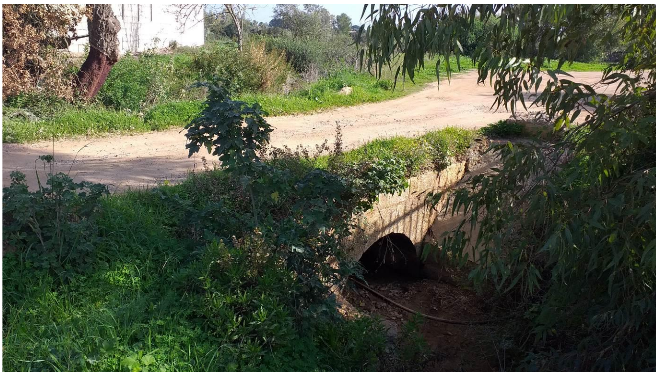
Figura 10: foto del ponte n°4 da rinforzare/sostituire
