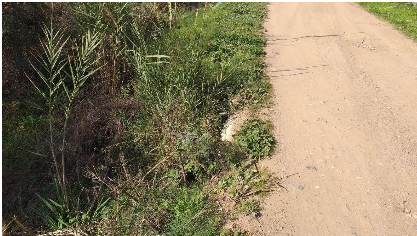
Figura 9: foto del ponte n°2 da rinforzare/sostituire
