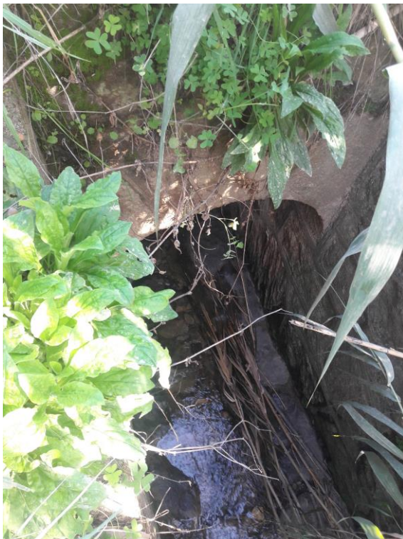
Figura 7: foto del ponte n°1 da rinforzare/sostituire
