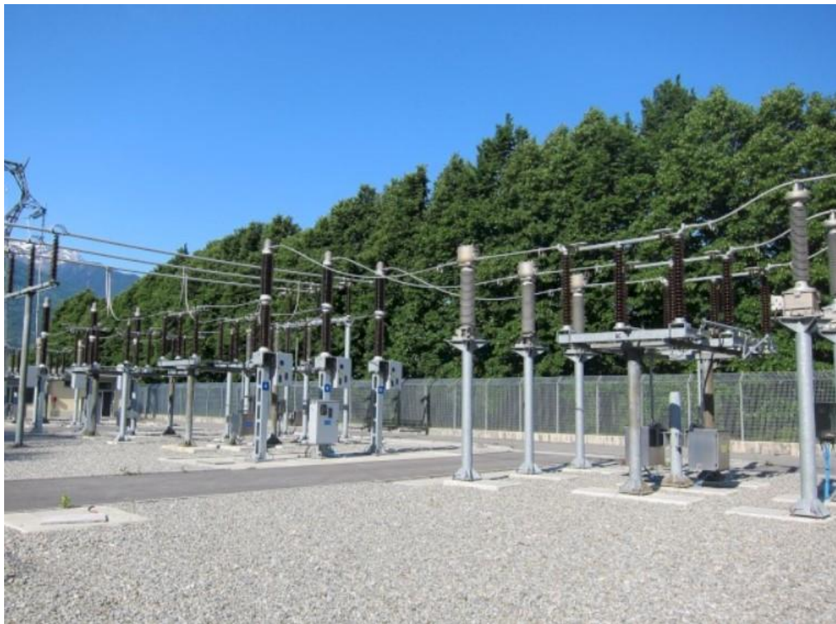
Fig. 24: esempio di sottostazione elettrica
