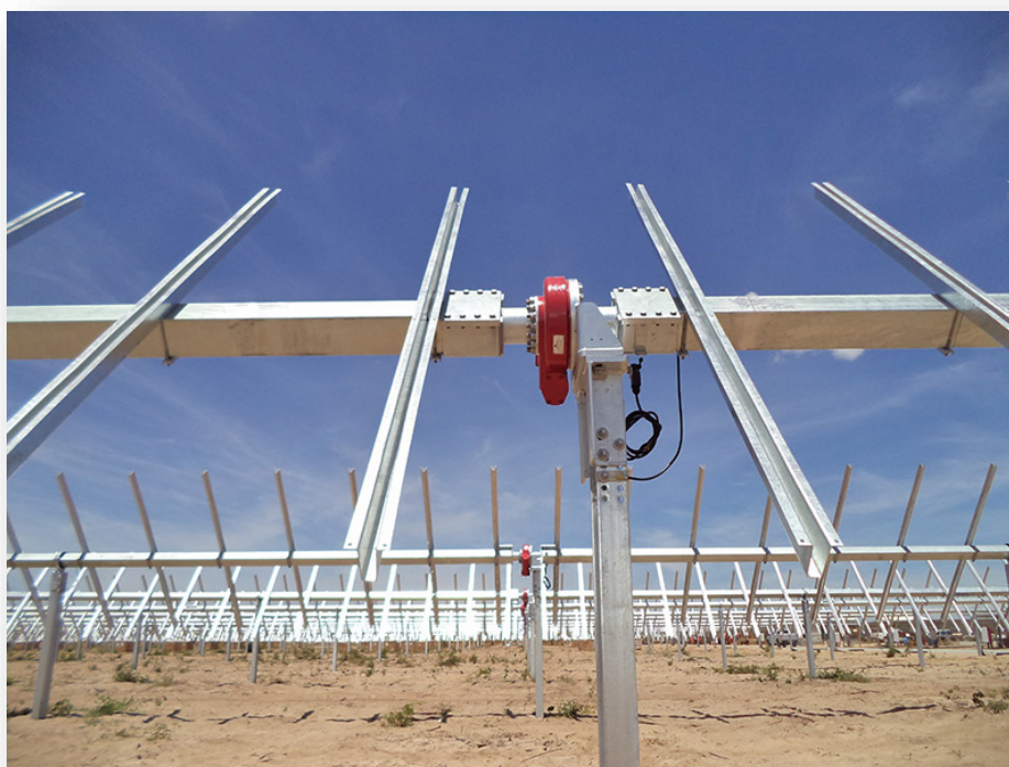
Figura 2 – Struttura dell'inseguitore solare monoassiale
