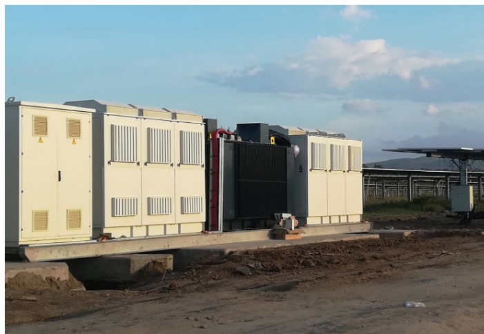
Figura 10 Esempio skid conversione
