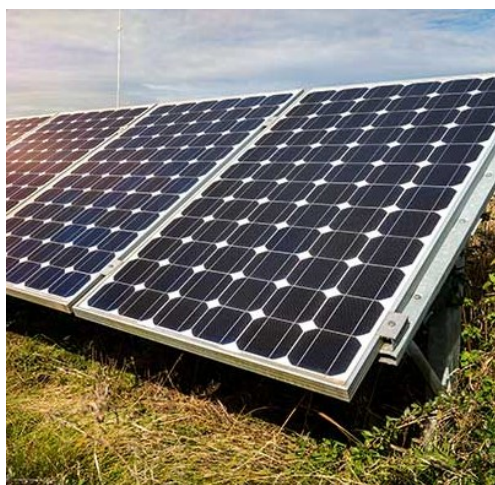
Figura 17: impianto agrovoltico con moduli di tipo monocristallino
