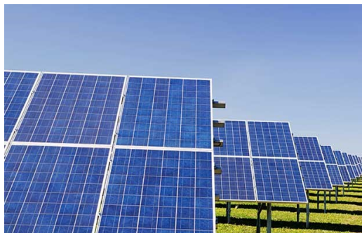
Figura 18: impianto agrovoltaiico con moduli di tipo policristallino
