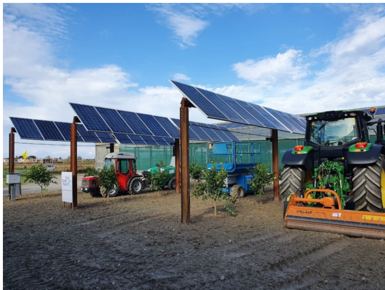
Figura 3-Inseguitore monoassiale con integrazione agrovoltaica (fonte: Convert Italia)
