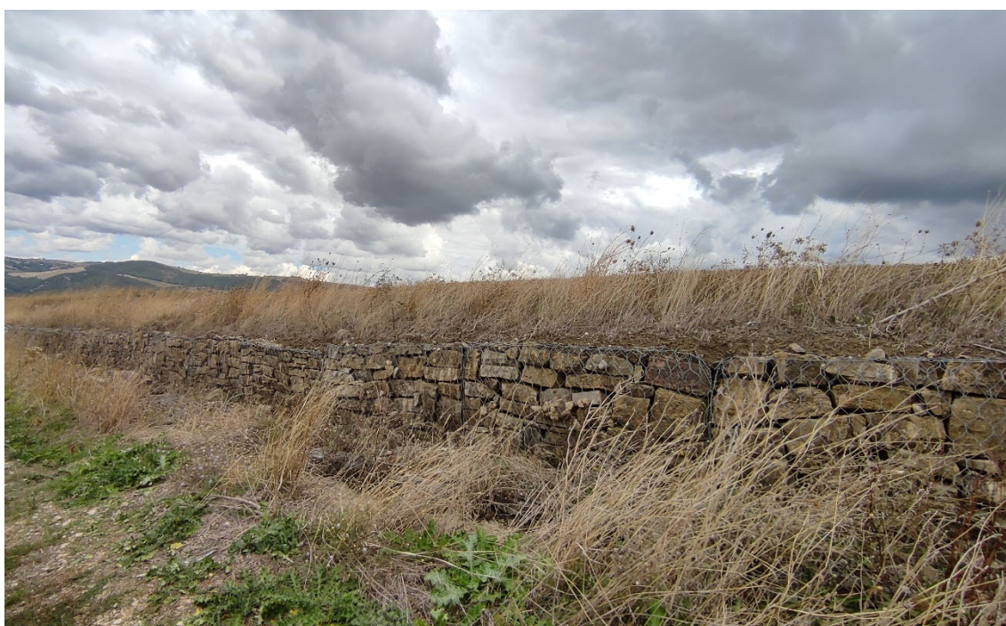
Figura 22 – Gabbionata in pietra di contenimento lungo la strada comunale San Benedetto
