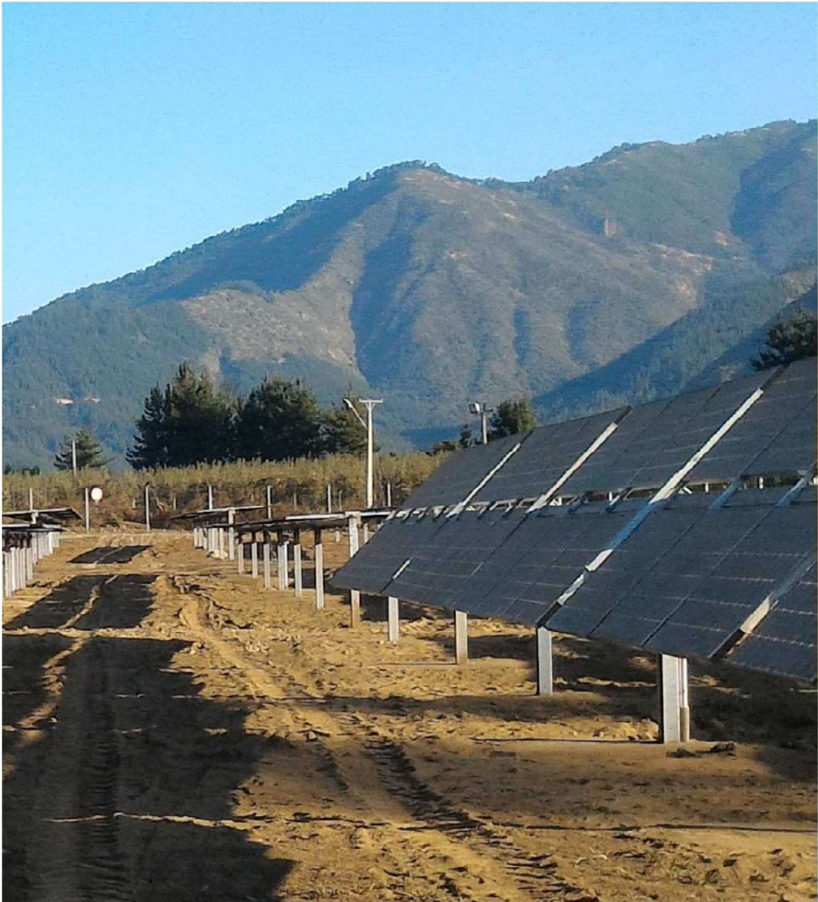
Fig. 6 Disposizione dei moduli fotovoltaici sui tracker
