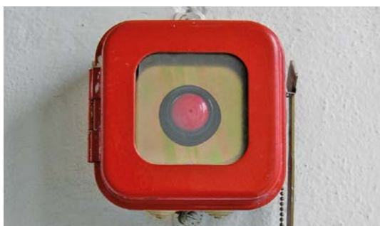
Figura 1.8: Pulsante di sgancio per apertura DG cabina
