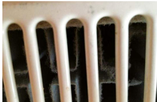
Figura 4.11: Stato di pulizia dei radiatori
