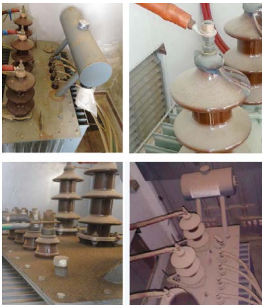
Figura 4.6: Condizioni di pulizia degli isolatori
