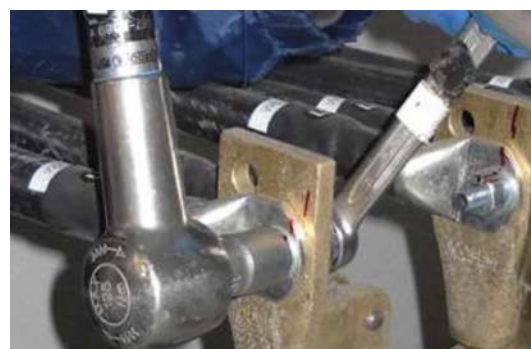
Figura 4.12: Stato di serraggio delle connessioni
