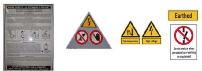
Figura 1.6: Cartelli tipici installati in cabina
