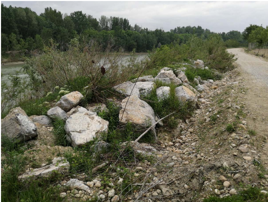
Figura 16: Zona di rottura dell'argine con depositi di ghiaie e ciottoli e massi collocati a protezione.
