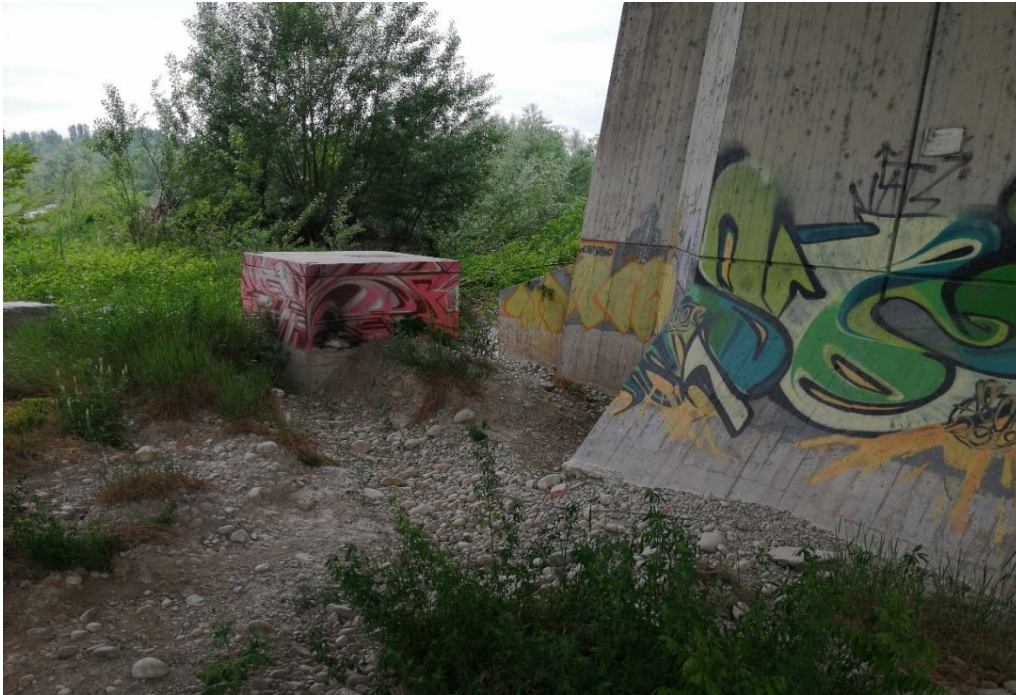
Figura 17: Segnali di erosione ai piedi della pila in sponda destra.
