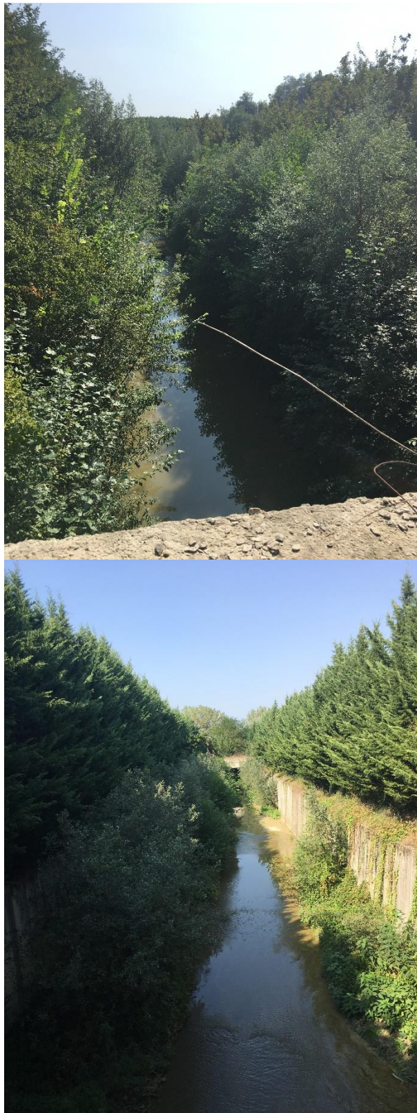
Figura 14 – Drizzagno, condizioni di stato attuale. Foto sx: tratto a monte del primo scatolare, vista da valle; foto dx: tratto intercluso tra i due scatolari, vista da monte.
