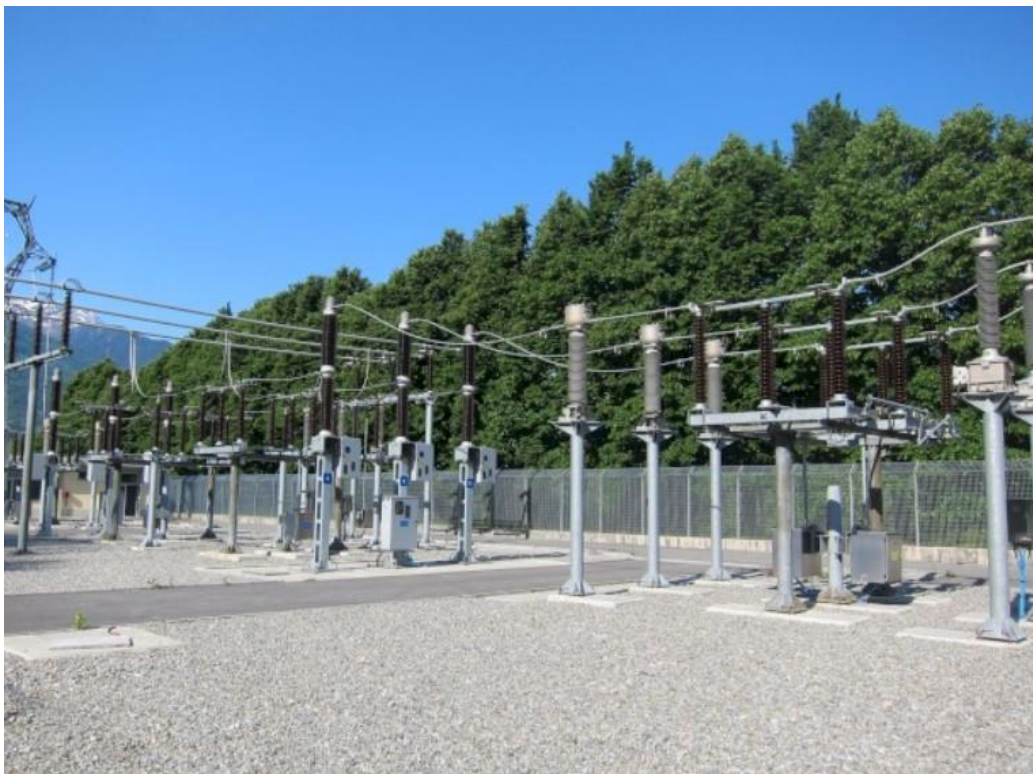
Fig. 30: esempio di sottostazione elettrica
