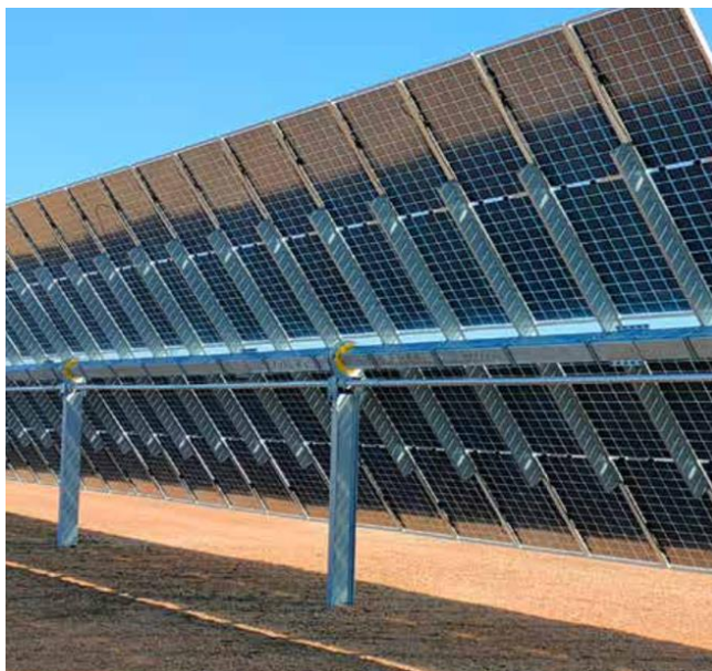
Figura 4 – Particolare Inseguitori mono assiali (Est-Ovest)
