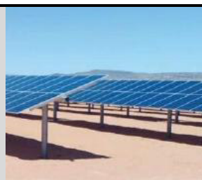
Impianto monoassiale (Inseguitore di rollio)
