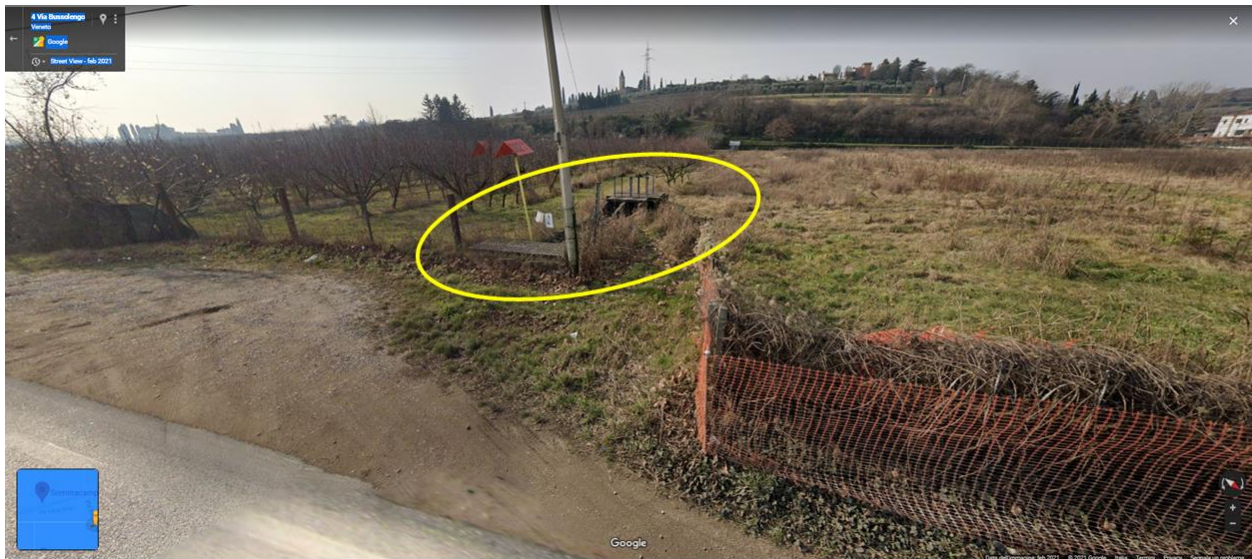
Foto 3 – dettaglio tombotto e canaletta relativi al canale lungo la Via Bussolengo-SP26
