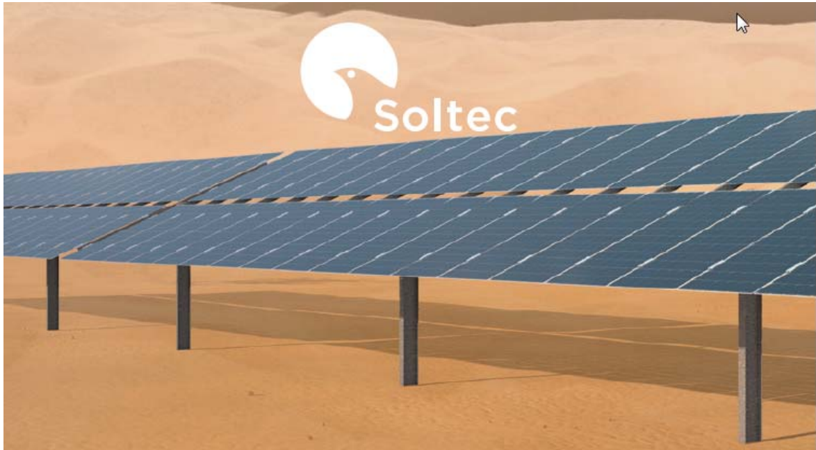
Figura 13. Particolare dell'inseguitore SOLTEC, con pannelli montati perpendicolarmente all'asse di rotazione.
