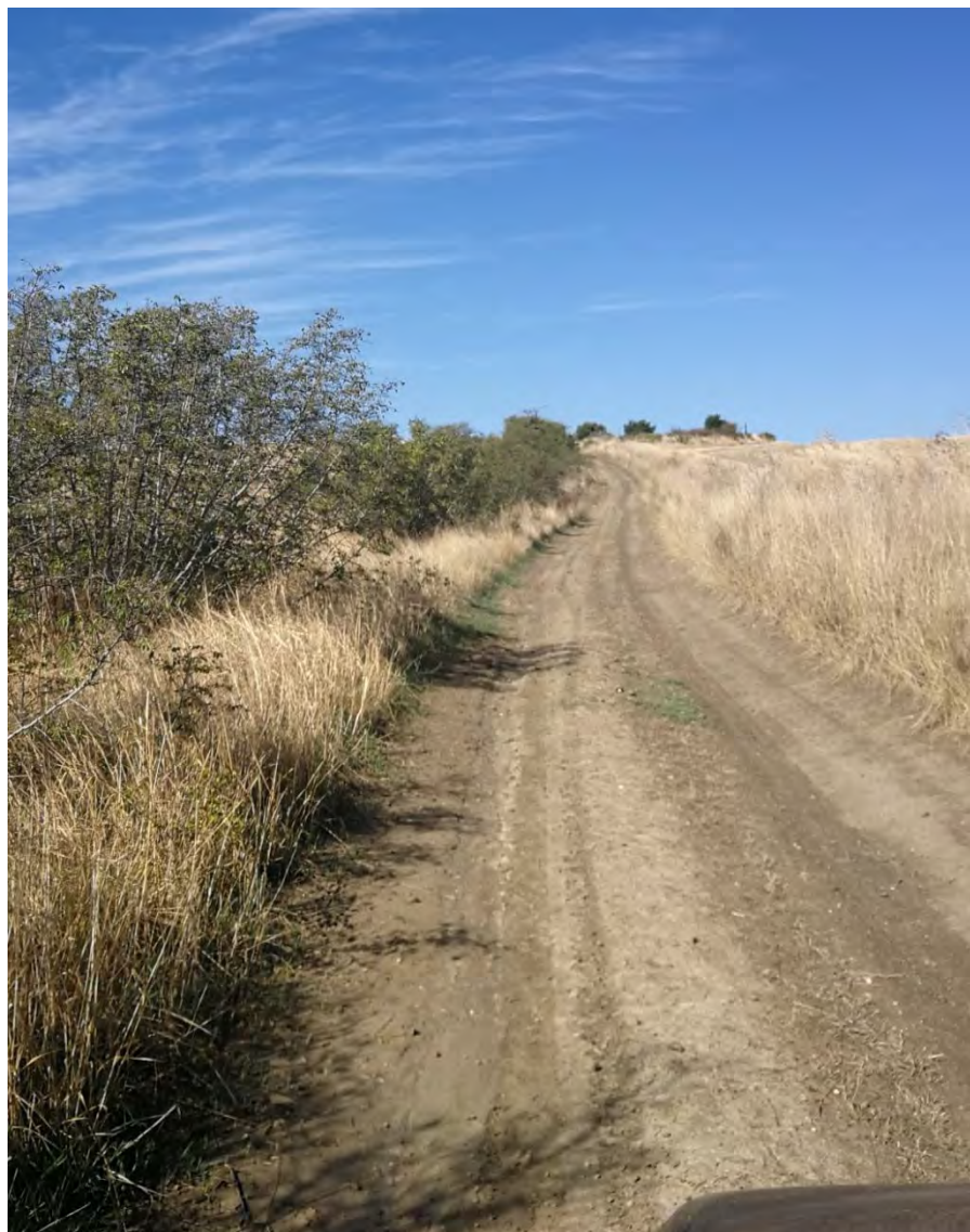
Figura 1.9: Tratto di strada "Ponte dell'Abbadia". La viabilità si presenta di modeste dimensioni e con manto sterrato e sconnesso.
