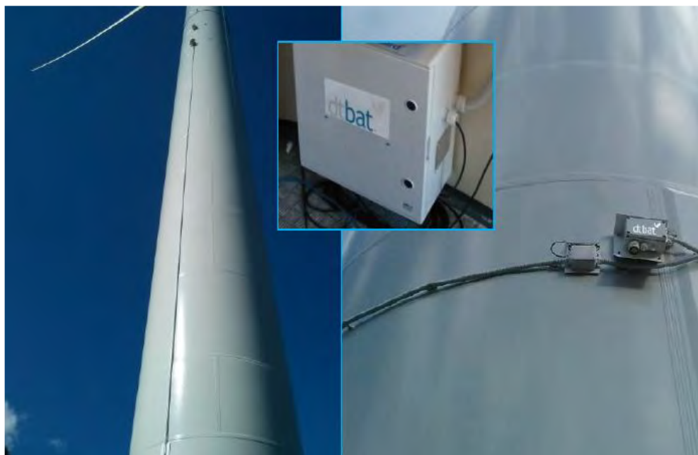
Figura 5.4: I sensori del sistema DTBat® prodotti dalla società Liquen Consultoria Ambientale S.l.
