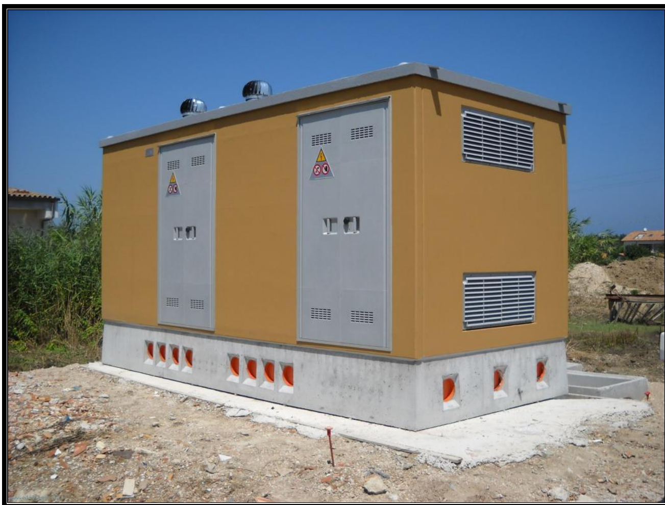
FIGURA 9 - ESEMPIO DI CABINA DI PARALLELO MT
