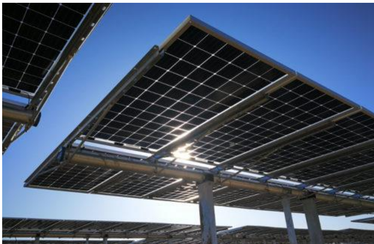
Figura 2.7 Esempio di struttura a tracker monoassiale
