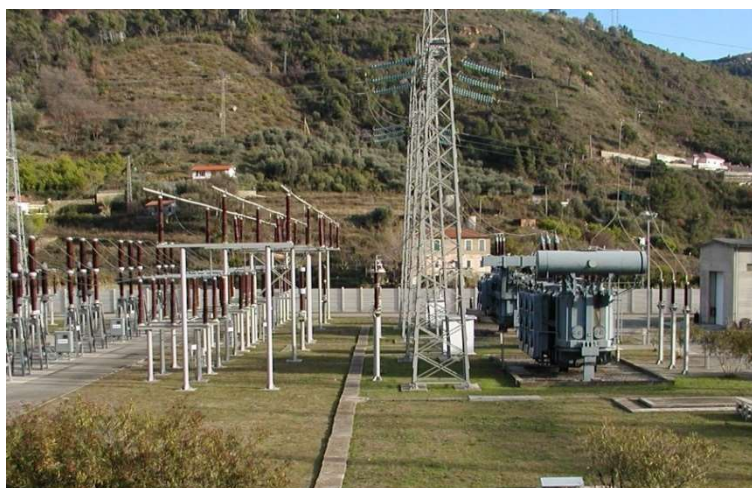
Figura 1.3: Esempio di sottostazione di trasformazione
