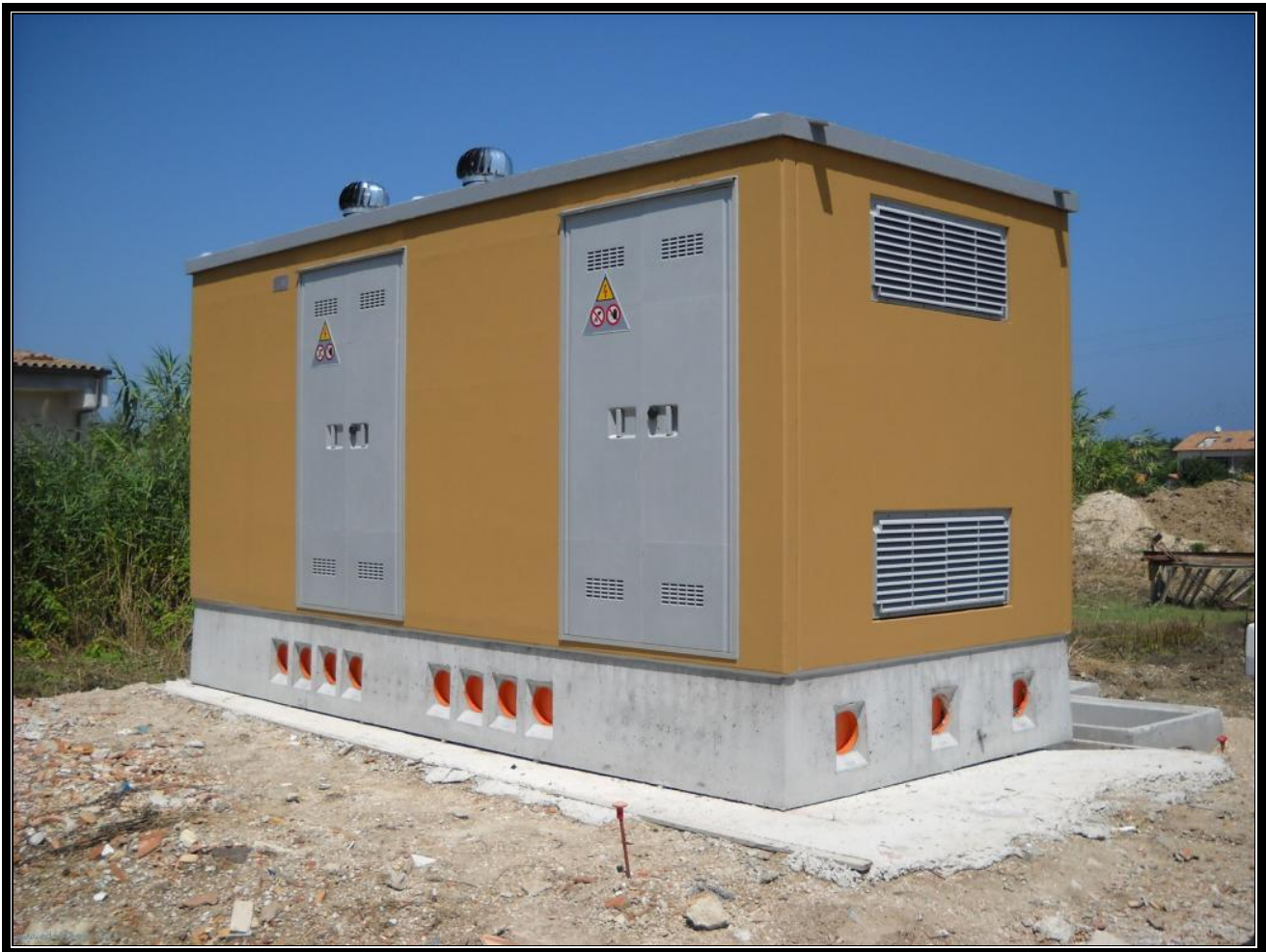
FIGURA 9 - ESEMPIO DI CABINA DI PARALLELO MT
