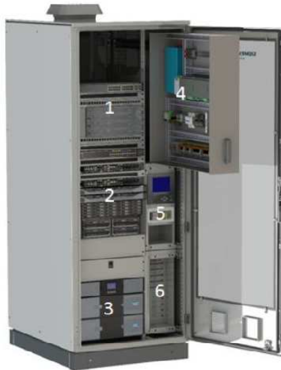
Figura 1 | Esempio di un Armadio SCADA
