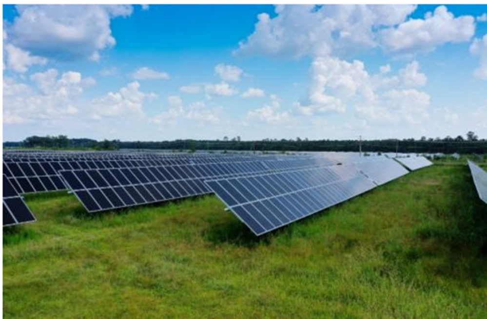
Figura 4.3 Esempio di struttura fissa monoassiale.
