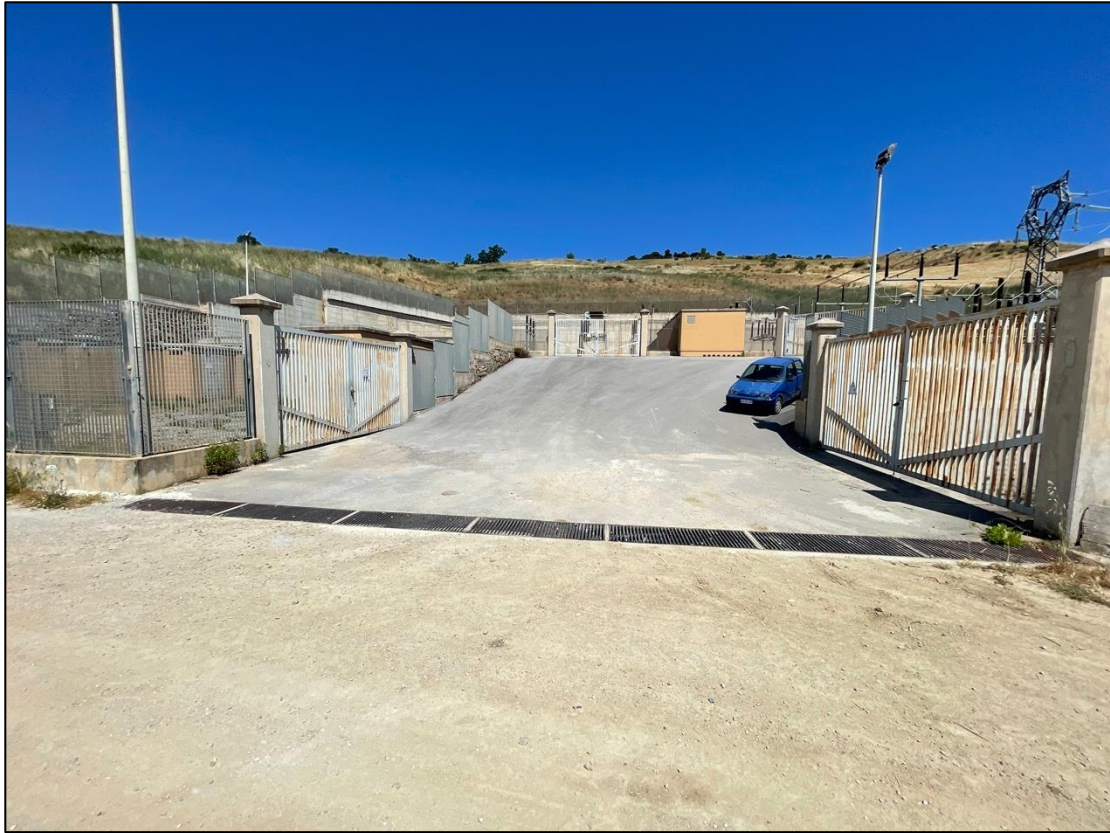
Foto 27 - Panoramica UR 04 (Stazione elettrica "Alia")
